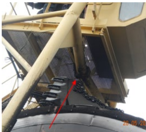
a) Oštećenje poprečnog stuba pre sanacije
