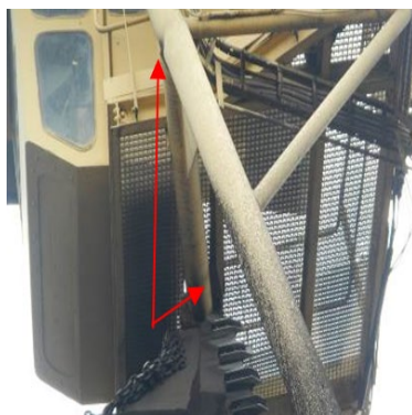
a) Desna strana konstrukcije, savijanje nosača i otkazi ZS
