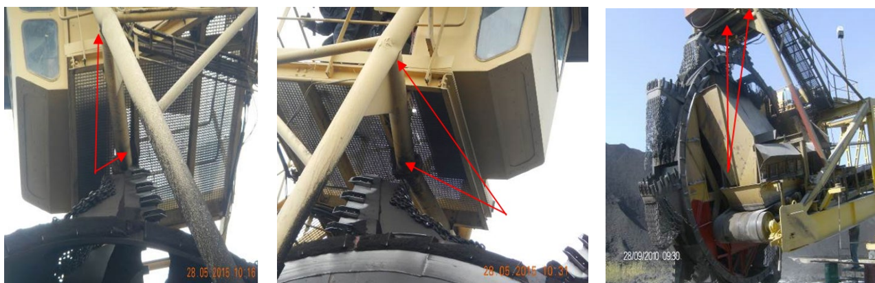
a) Desna strana konstrukcije, savijanje nosača i otkaz ZS b) Savijanje poprečnog nosača i oštećenja ZS na prirubnici i vertikalnom stubu c) Leva strana konstrukcije, savijanje nosača i otkazi ZS
