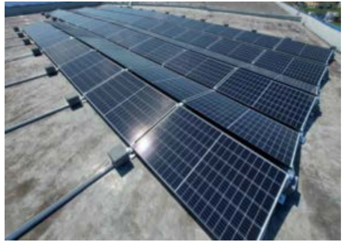
Slika 1. Solarna elektrana na krovu NTP Čačak
