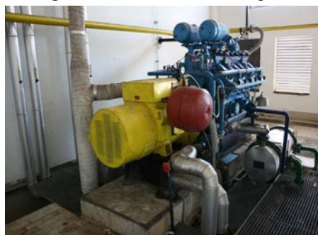
Sl. 2. Sprega gasnog motora i generatora
