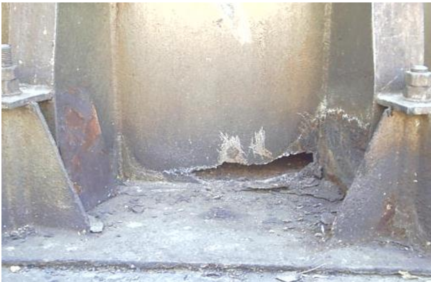
Sl.3 Oštećenje korene sekcije dimnjaka.
